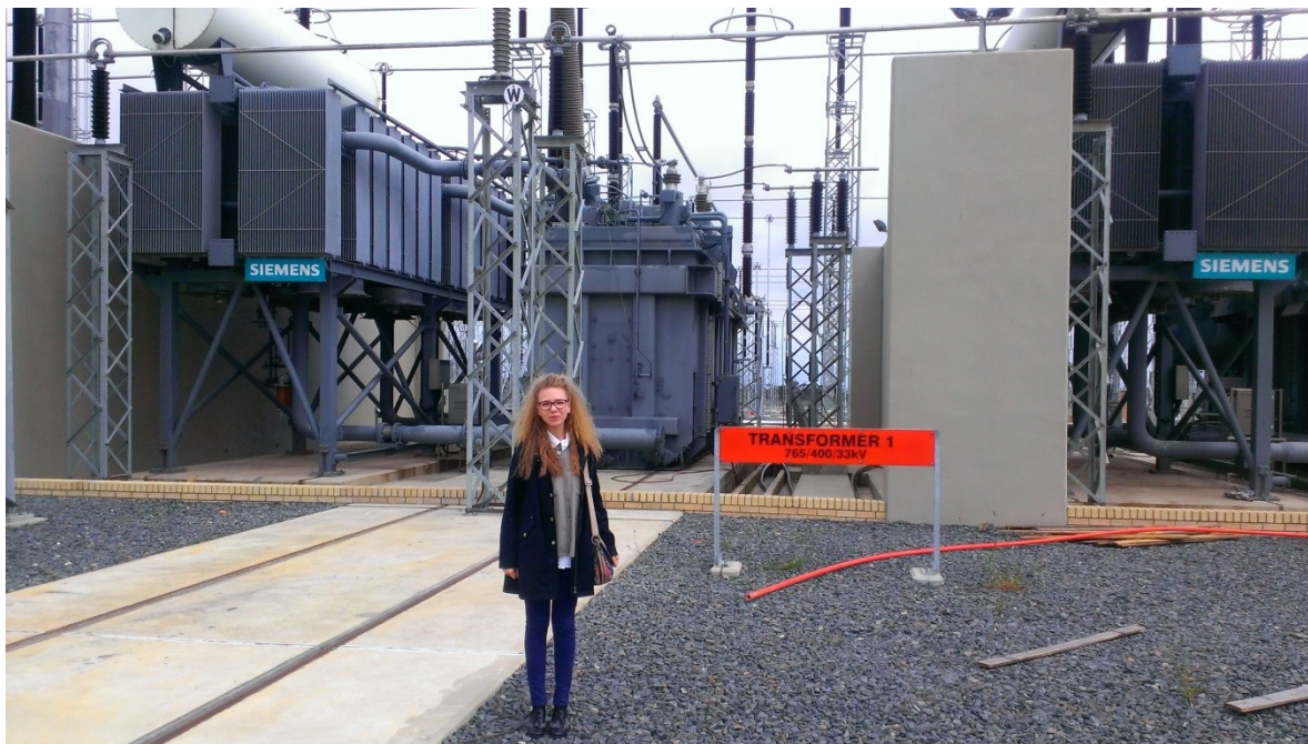
Рисунок 13. ПС 765 кВ Стеррекус
